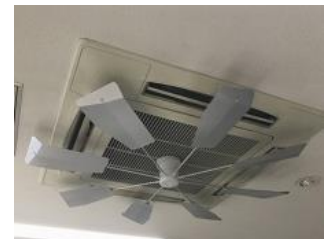
シーリングファンを取り付け、 室内の温度を一定に保っています (札幌)
