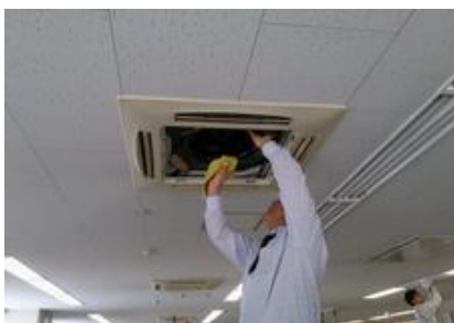
エアコンフィルターの清掃 (札幌)
